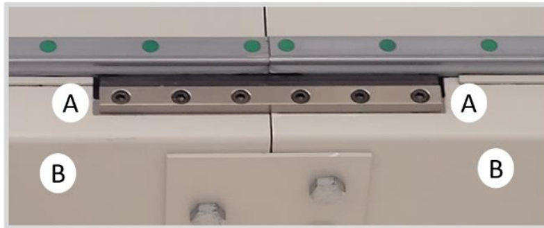
Figura 6. Zonas donde pueden producirse grietas
